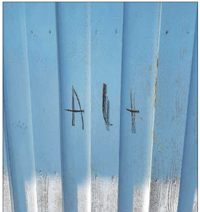
Unnötige Kritzeleien an der Fassade
